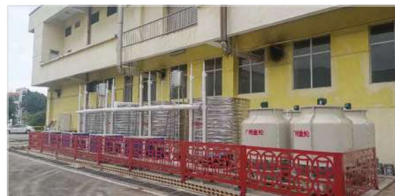
鹰金钱公司冰蓄冷制冷设备
